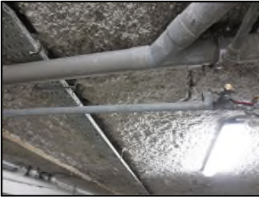
Photo N° 584 ECH-N°1 FLOCAGE -- PARKING Plafonds BLANC COTONNEUX
